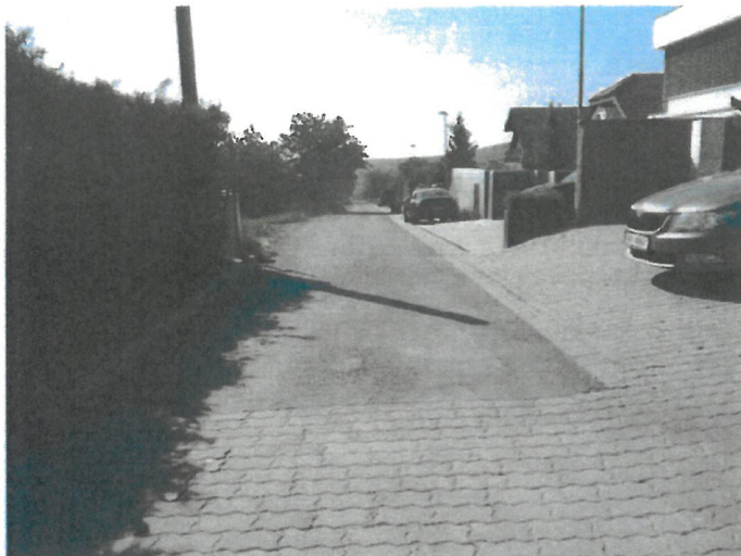
Navázání asfaltové komunikace na betonovou zámkovou dlažbu
